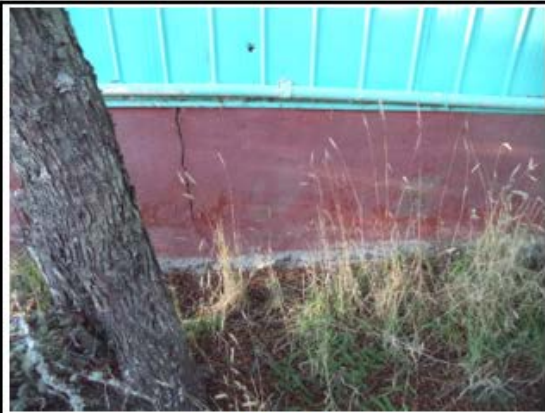
GRIETAS EN RADIER
