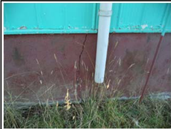
GRIETAS EN RADIER
